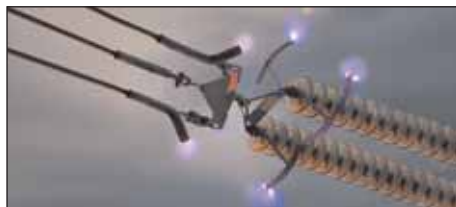
Рис. 161. Коронный разряд на проводах линии электропередачи
